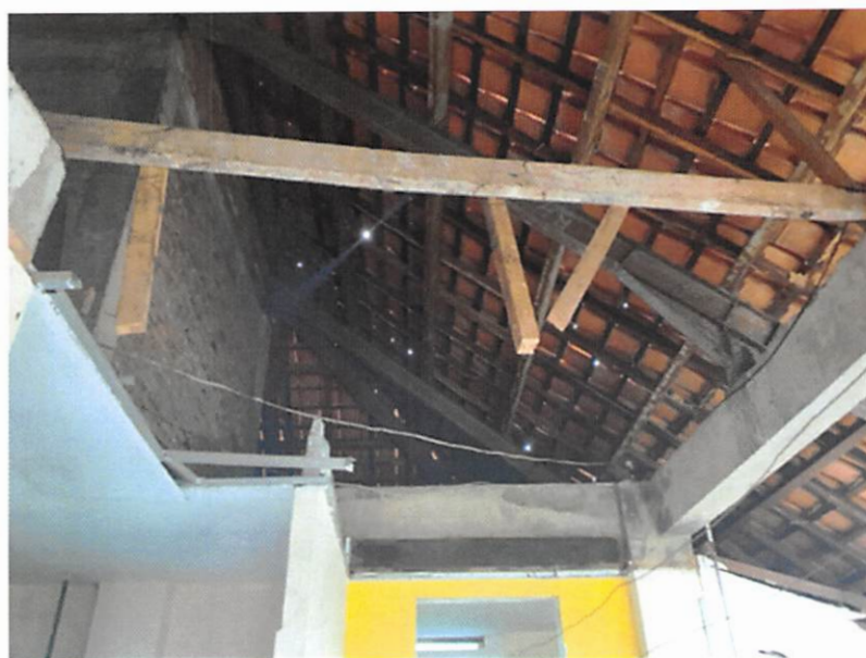
Gambar 4. Typical Kerusakan Atap dan Plafon Gedung D
